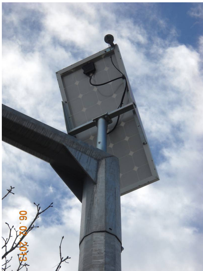
Figura 27. Sezione di monitoraggio e classificazione del traffico n° 1 (via Tarlati): particolare dell'alimentazione con pannello solare
