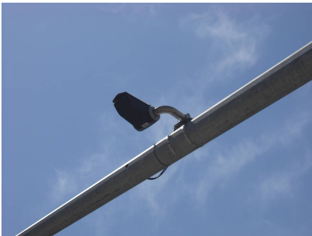
Figura 33. Sezione di monitoraggio e classificazione del traffico n° 3 (via Baldaccio): dettaglio del sistema di ancoraggio dei sensori al palo a sbraccio
