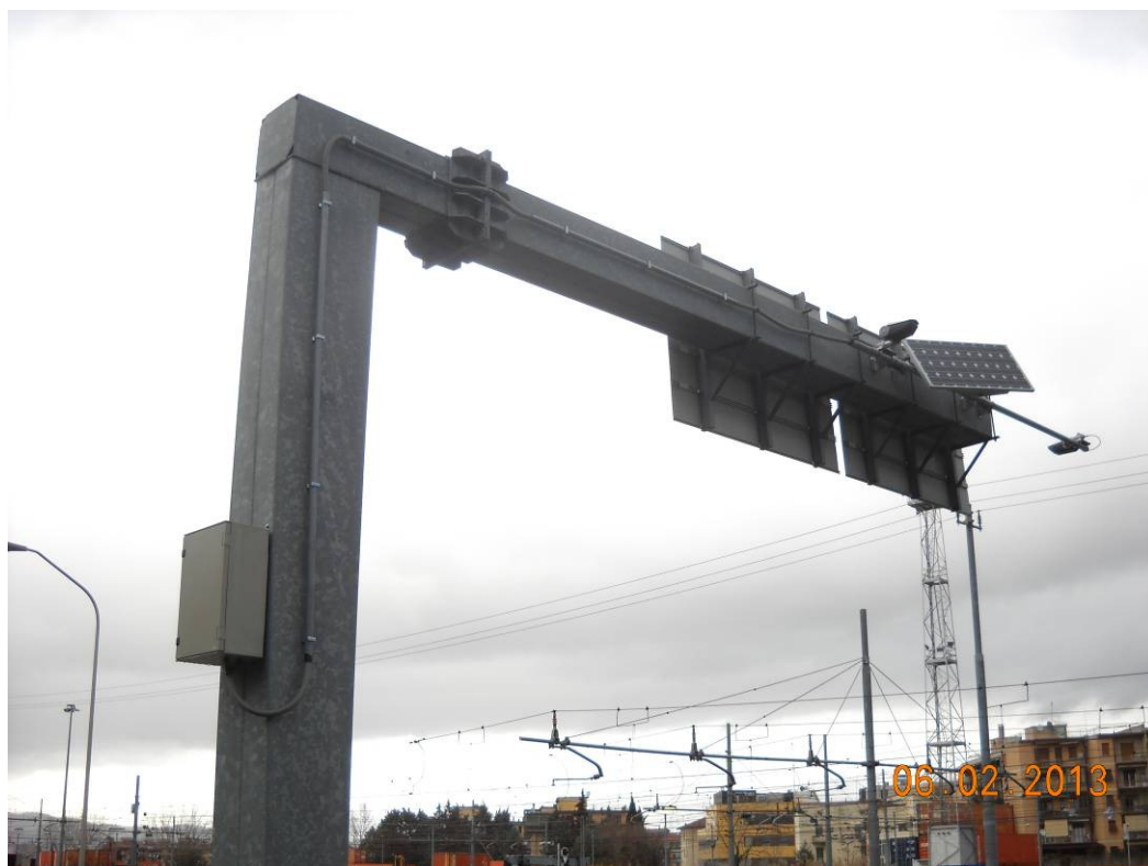
Figura 30. Sezione di monitoraggio e classificazione del traffico n° 2 (via Cittadini): soluzione adottata per l'installazione dei sensori su portale esistente e alimentazione con pannello solare
