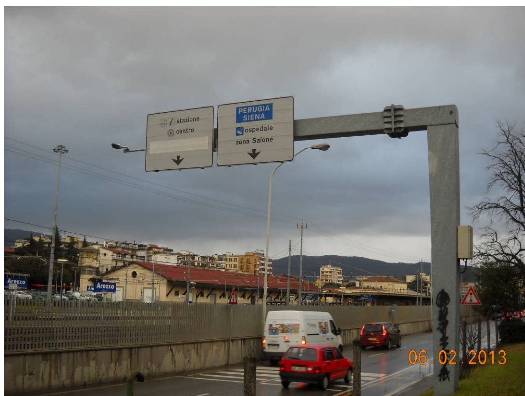
Figura 29. Sezione di monitoraggio e classificazione del traffico n° 2 (viale Cittadini): installazione dei sensori su portale esistente
