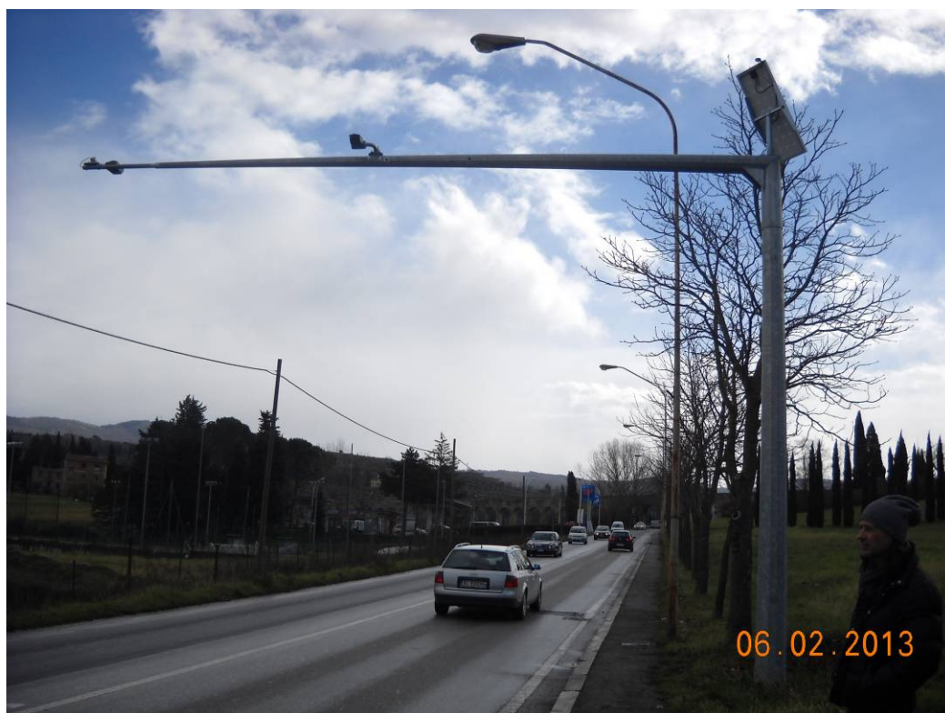
Figura 26. Sezione di monitoraggio e classificazione del traffico n° 1 (via Tarlati): installazione dei sensori su nuovo palo a sbraccio
